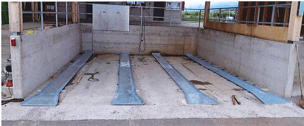
Figure 1 - Rails de guidage en acier posé en 2020 pour les bennes de verre et plastique
