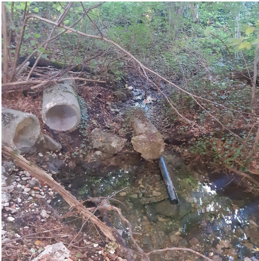
FIGURE 23 : RÉSURGENCE DE LA SOURCE ENCOMBRÉE, À ASSAINIR
